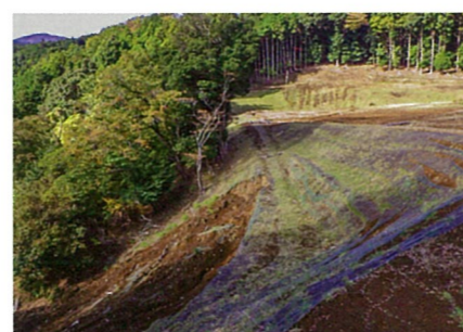
今なお続くがけ地の崩落(A工区の現状)
