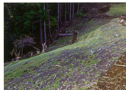
今なお続くがけ地の崩落(B工区の現状)
